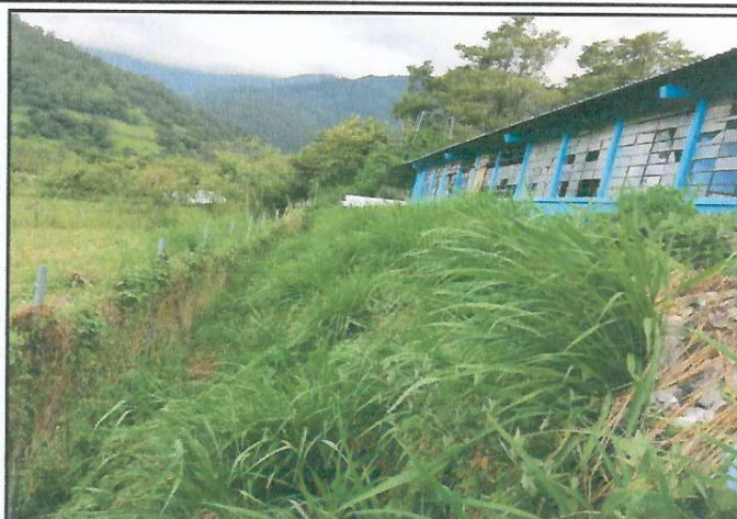
Foto 2: Necesidad de mejoramiento area perimetral (muro contención) para que el INEB de Telesecundaria.
